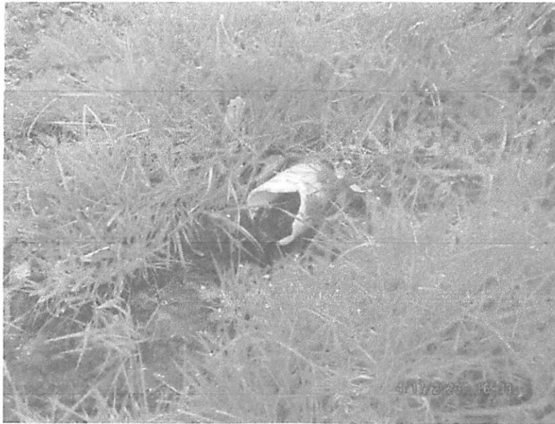
Dark effluent at discharge point.
